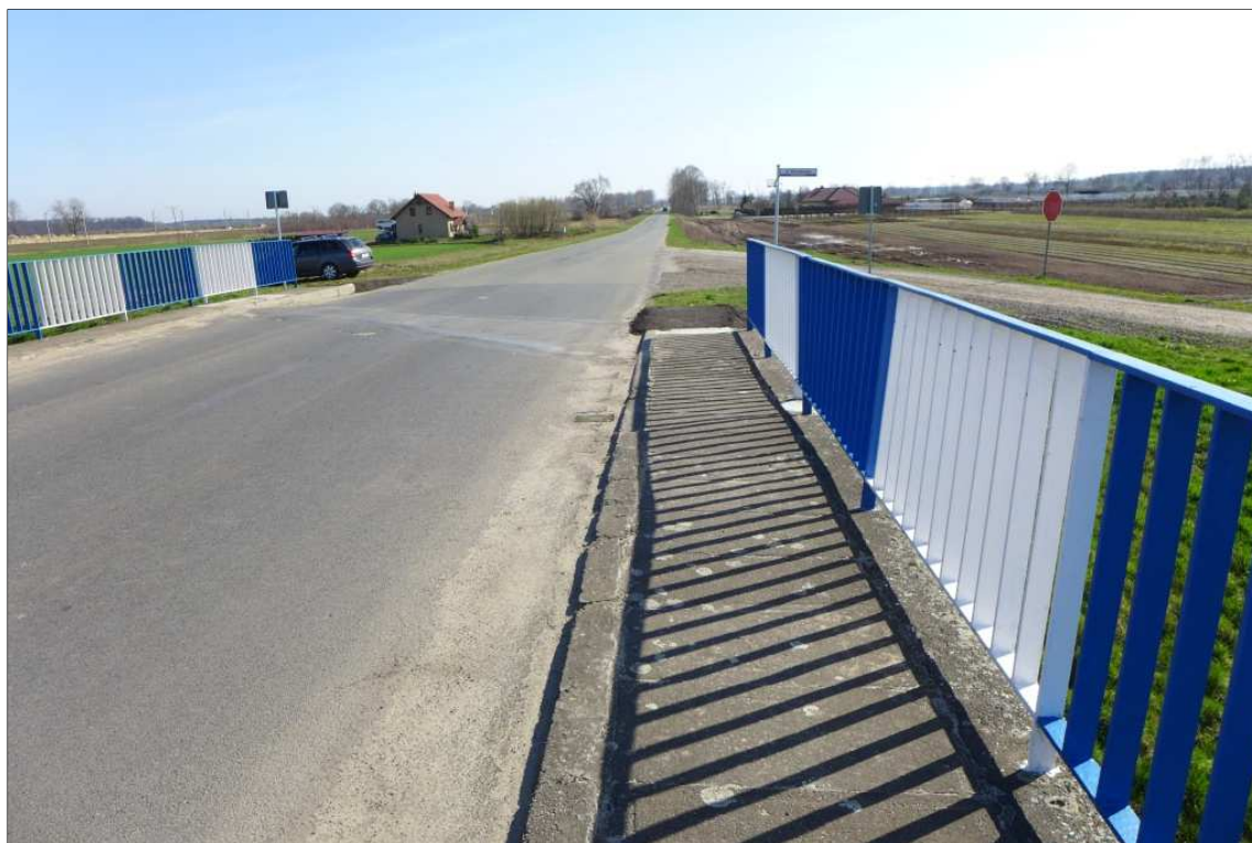
Fot. 12 – Chodnik od strony dolnej wody - widoczne nierówności i zanieczyszczenia, ubytki i spękania betonu krawężników.
