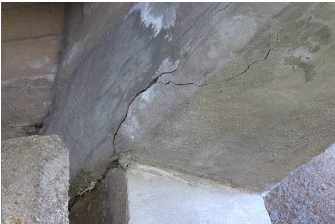
Fot. 31 – Widoczne spękania dźwigara głównego w strefie podparcia.
