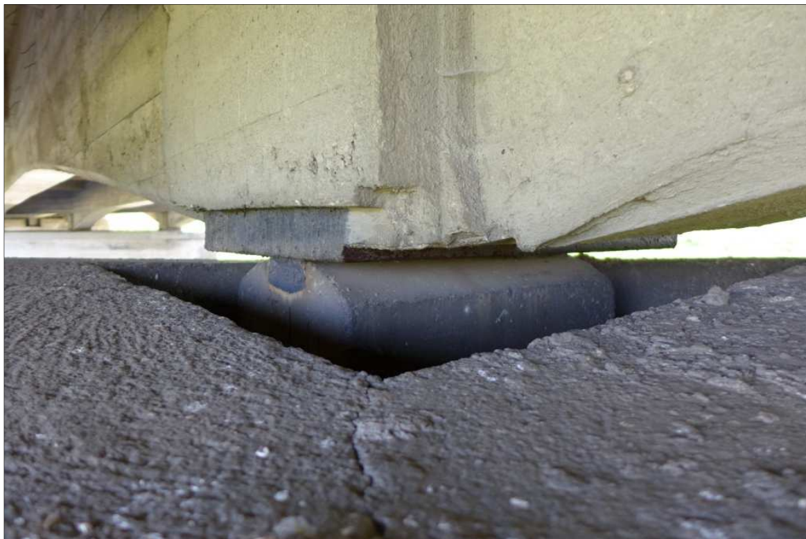
Fot. 33 – Łożysko betonowe na filarze - widoczna korozja powierzchniowa części stalowej.
