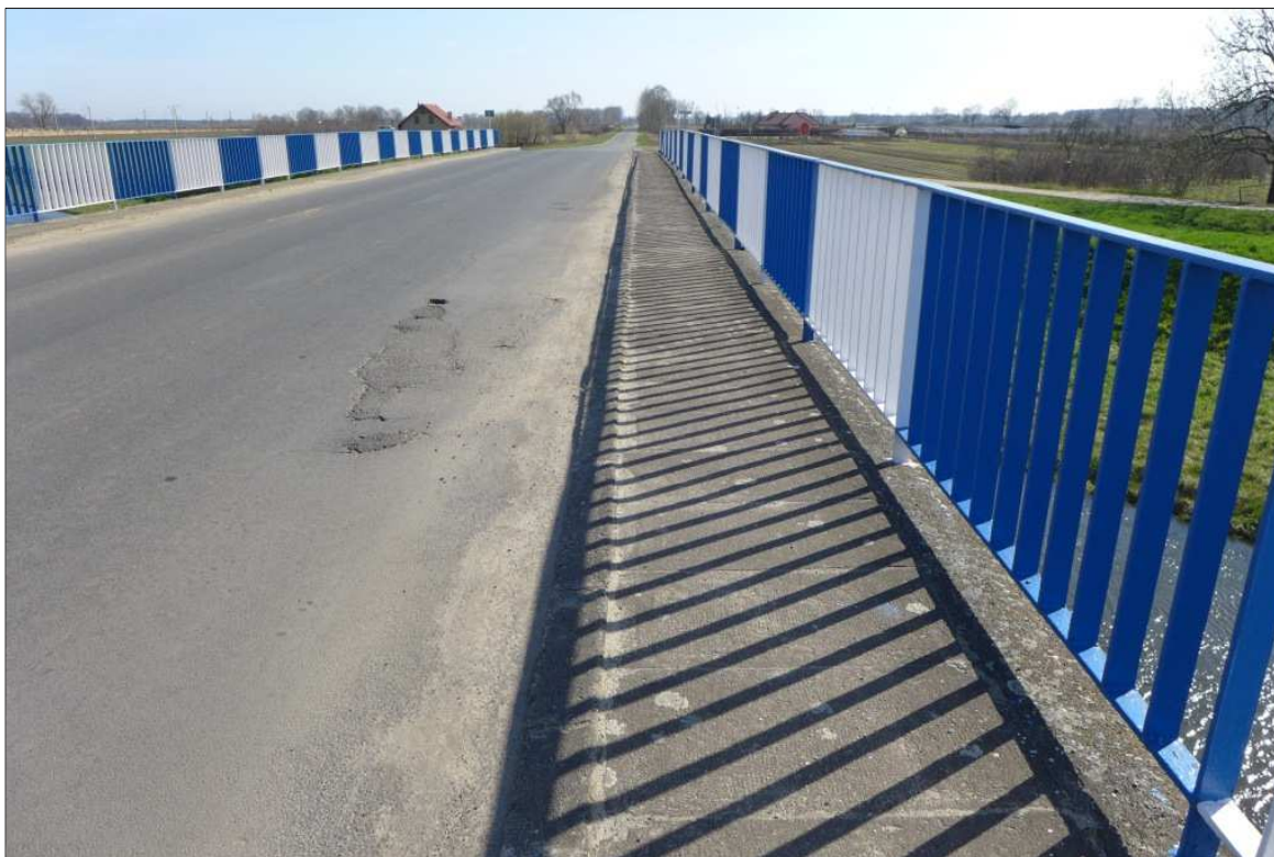
Fot. 8 – Nawierzchnia jezdni - widoczne ubytki i wykruszenia, zanieczyszczenie stref przykrawężnikowych.
