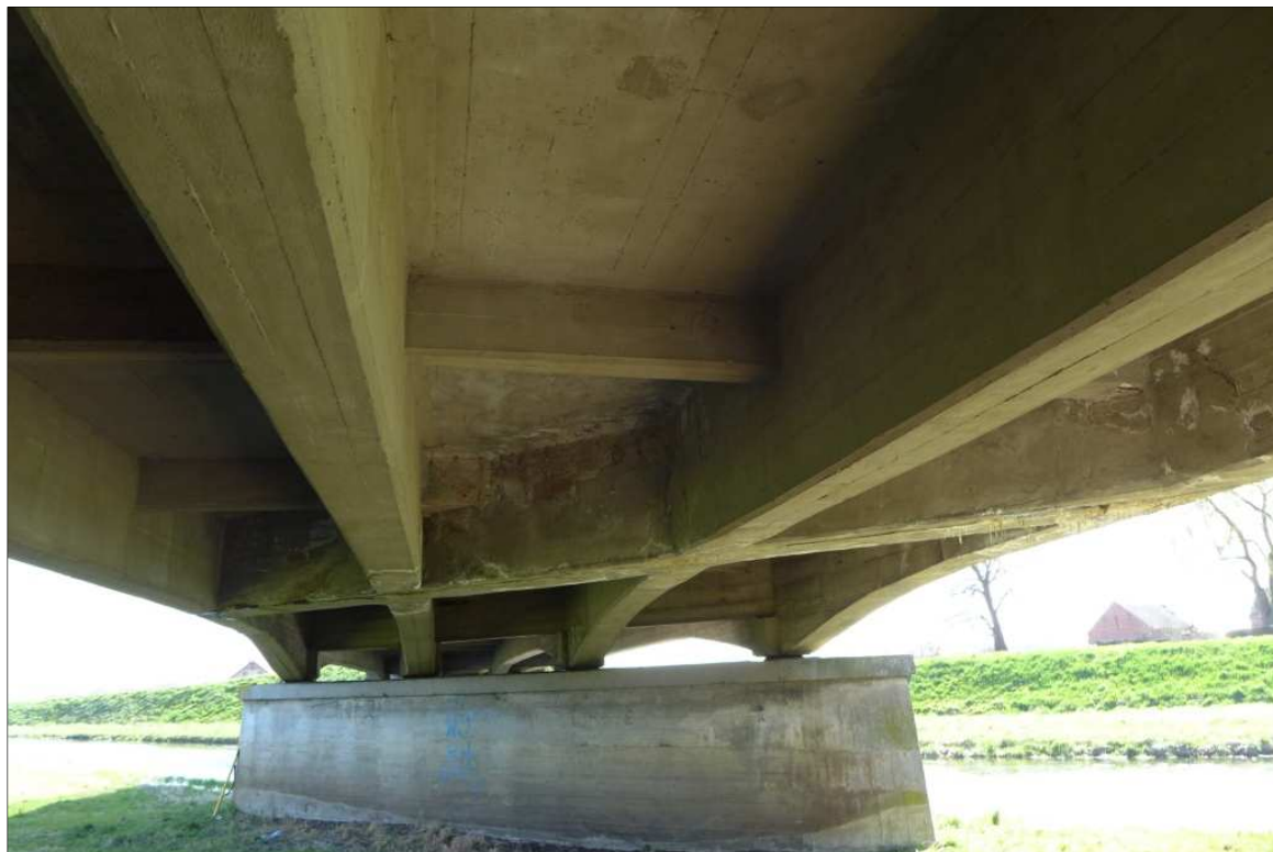
Fot. 15 – Konstrukcja nośna (przęsło od strony Korzeńska) - widoczne uszkodzenia w obrębie przegubu (zacieki, wykwity, osady i korozja betonu).
