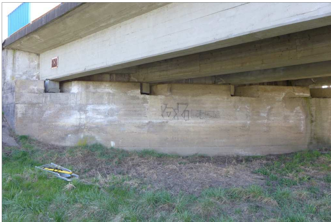
Fot. 28 – Przyczółek lewobrzeżny - widoczne osady i wykwyty oraz zanieczyszczenia.
