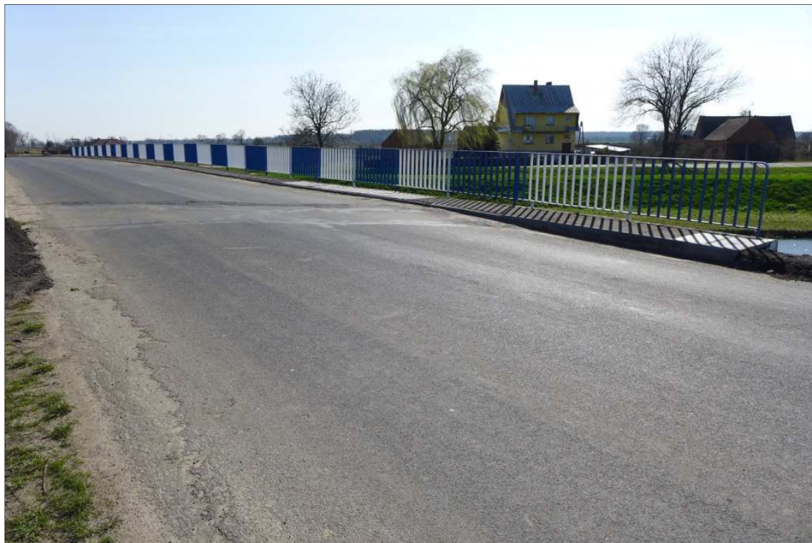
Fot. 7 – Nawierzchnia jezdni na dojazdach - widoczne podniesienie jezdni, deformacje nawierzchni.
