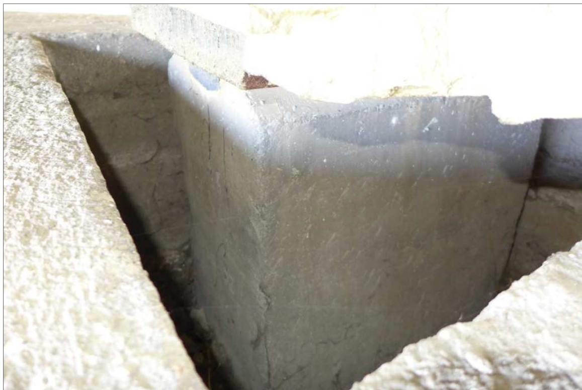
Fot. 34 – Łożysko betonowe na filarze - widoczne zanieczyszczenia.
