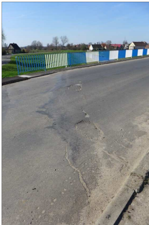
Fot. 5 – Nawierzchnia jezdni - widoczne deformacje i spękania w obrębie strefy dylatacyjnej.
