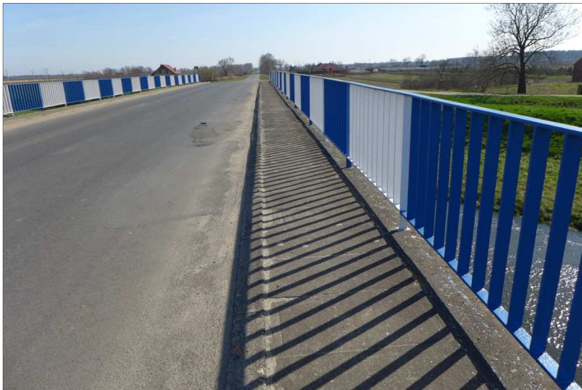
Fot. 11 – Chodnik od strony dolnej wody - widoczne nierówności i zanieczyszczenia, ubytki i spękania betonu krawężników.
