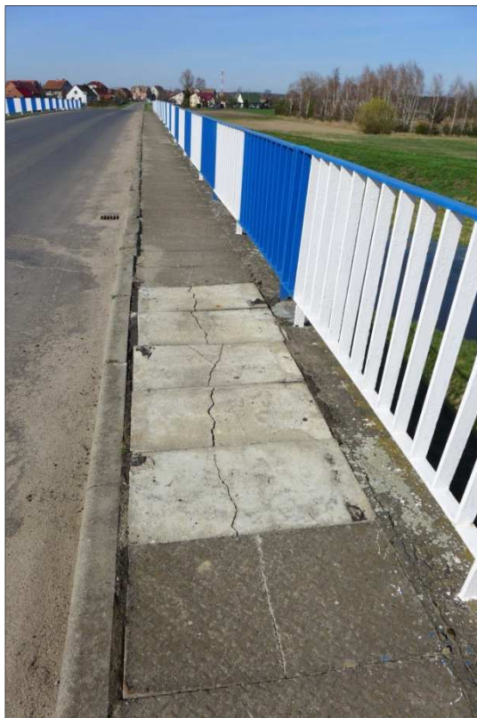
Fot. 9 – Chodnik od strony górnej wody - widoczne pęknięcia na płytach chodnikowych.
