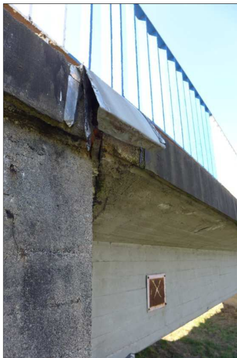
Fot. 14 – Gzyms od strony dolnej wody - widoczne wykruszenia betonu, deformacja blachy osłonowej.
