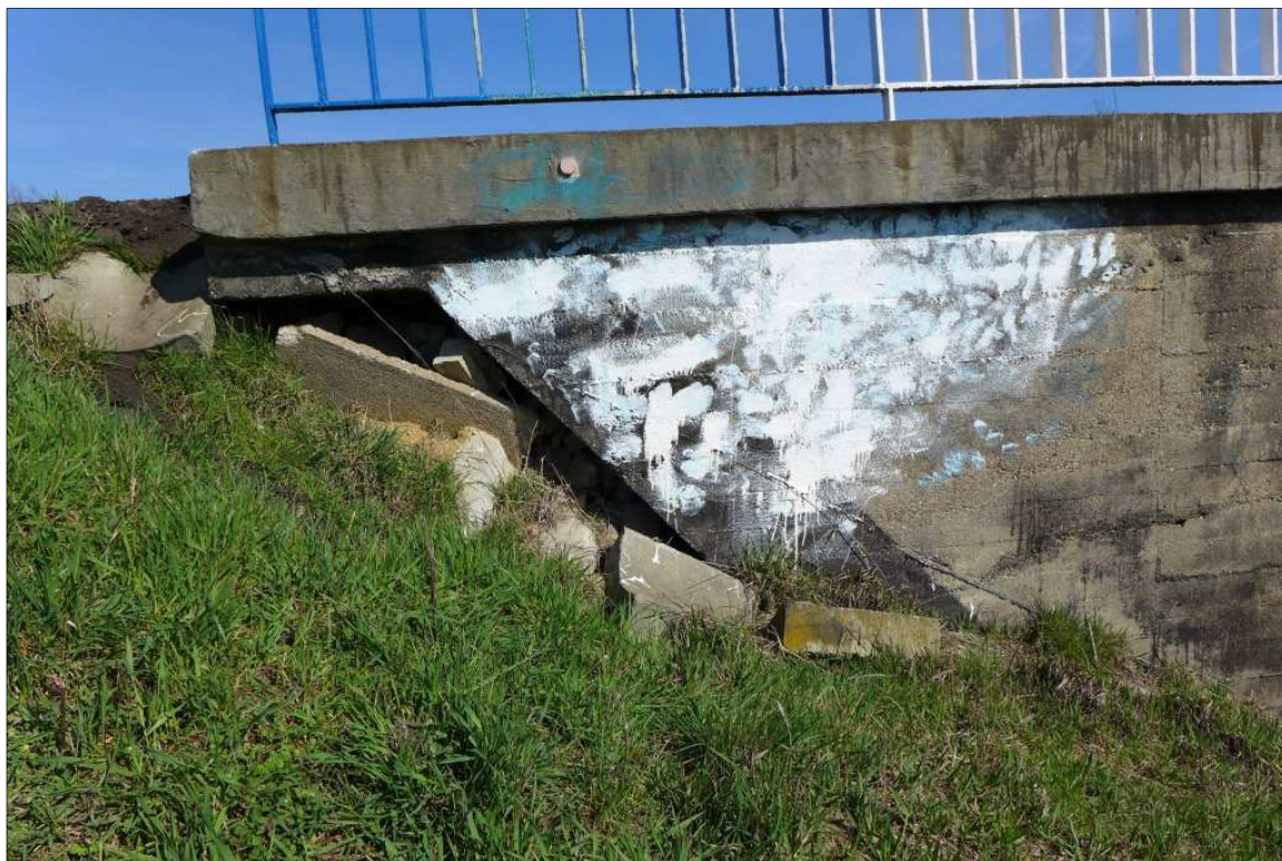
Fot. 26 – Skrzydełko prawobrzeżne od strony dolnej wody - widoczne obsunięcie stożka nasypowego, w wyniku czego nastąpiło odsłonięcie skrzydełka (zagroża bezpieczeństwu i stateczności całej podpory).
