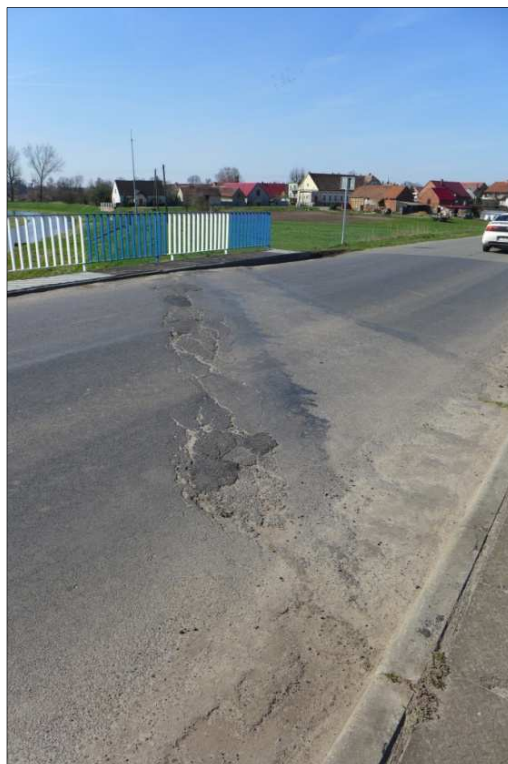
Fot. 6 – Nawierzchnia jezdni - widoczne deformacje i spękania z wykruszeniami w obrębie strefy dylatacyjnej.
