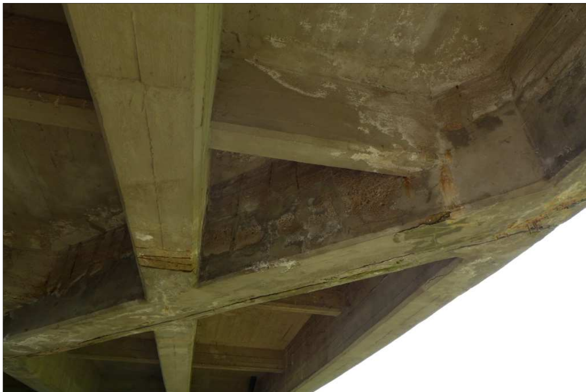
Fot. 23 – Konstrukcja nośna - widoczna rozległa korozja betonu i stali konstrukcji nośnej w miejscu przegubu, na skutek przecieków wody. Widoczne również przecieki, osady i wykwity.
