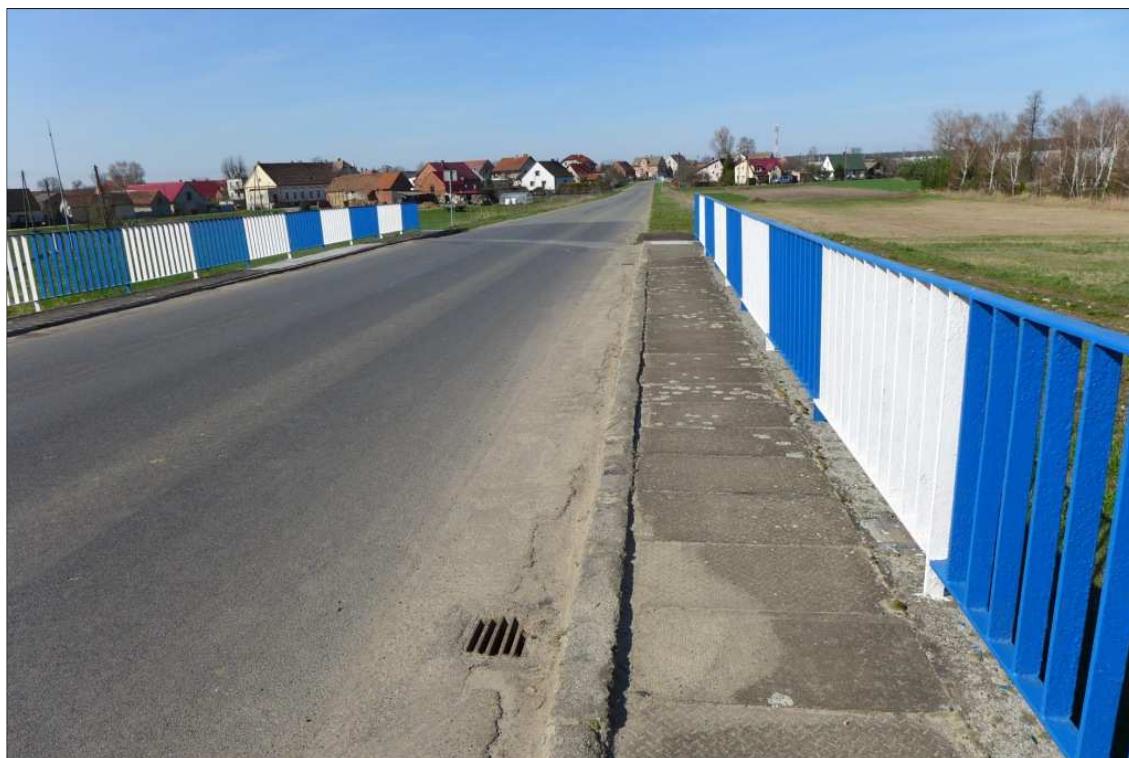
Fot. 10 – Chodnik od strony górnej wody - widoczne ubytki betonu krawężników, obniżenia płyt chodnikowych, zanieczyszczenia. Widoczne również częściowe przekrycie kratki ściekowej oraz zanieczyszczenia i deformacje nawierzchni w strefach przykrawężnikowych.
