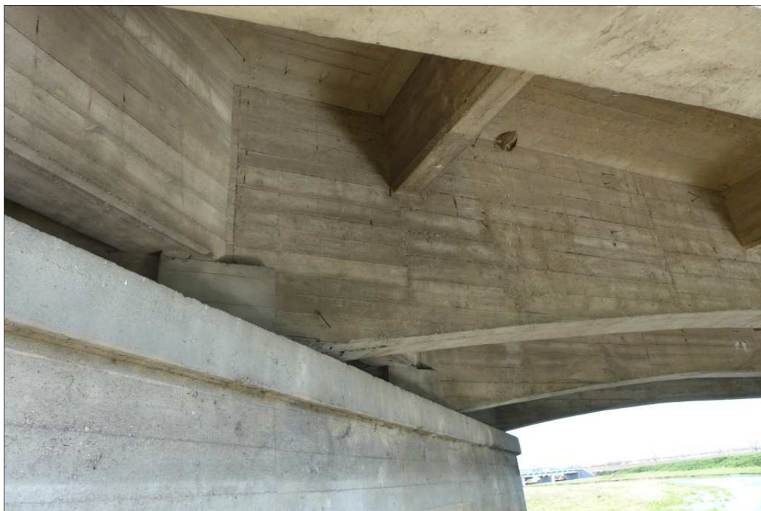
Fot. 20 – Konstrukcja nośna (przęsło nurtowe) - lokalne złuszczenia betonu.
