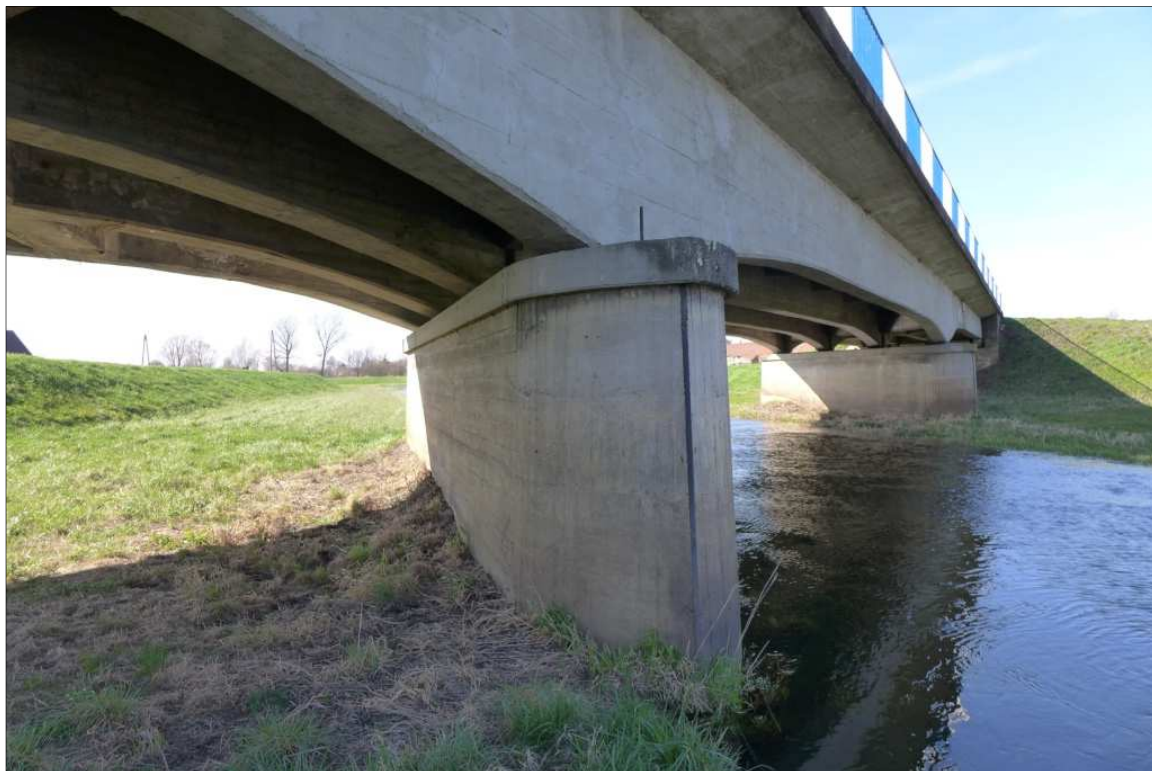
Fot. 27 – Filar - widoczne lokalne osady i zawilgocenia.
