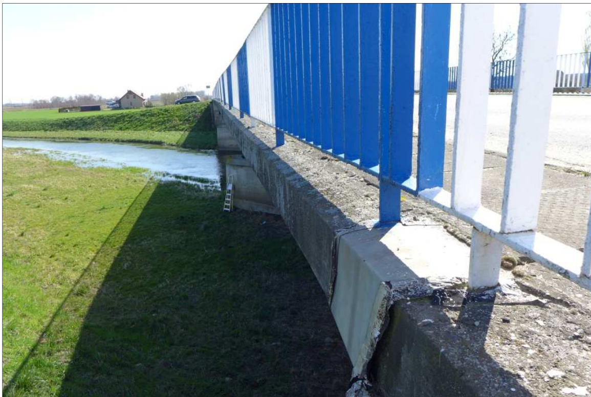
Fot. 13 – Gzyms od strony górnej wody - widoczne wykruszenia betonu, deformacja blachy osłonowej.
