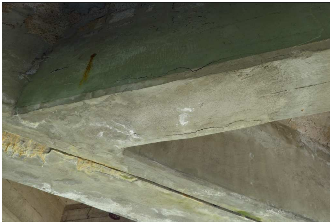
Fot. 18 – Konstrukcja nośna - widoczne pęknięcia otuliny betonowej dźwigara (najprawdopodobniej na skutek korozji prętów zbrojeniowych, co z kolei jest spowodowane przeciekami wody z przegubu).
