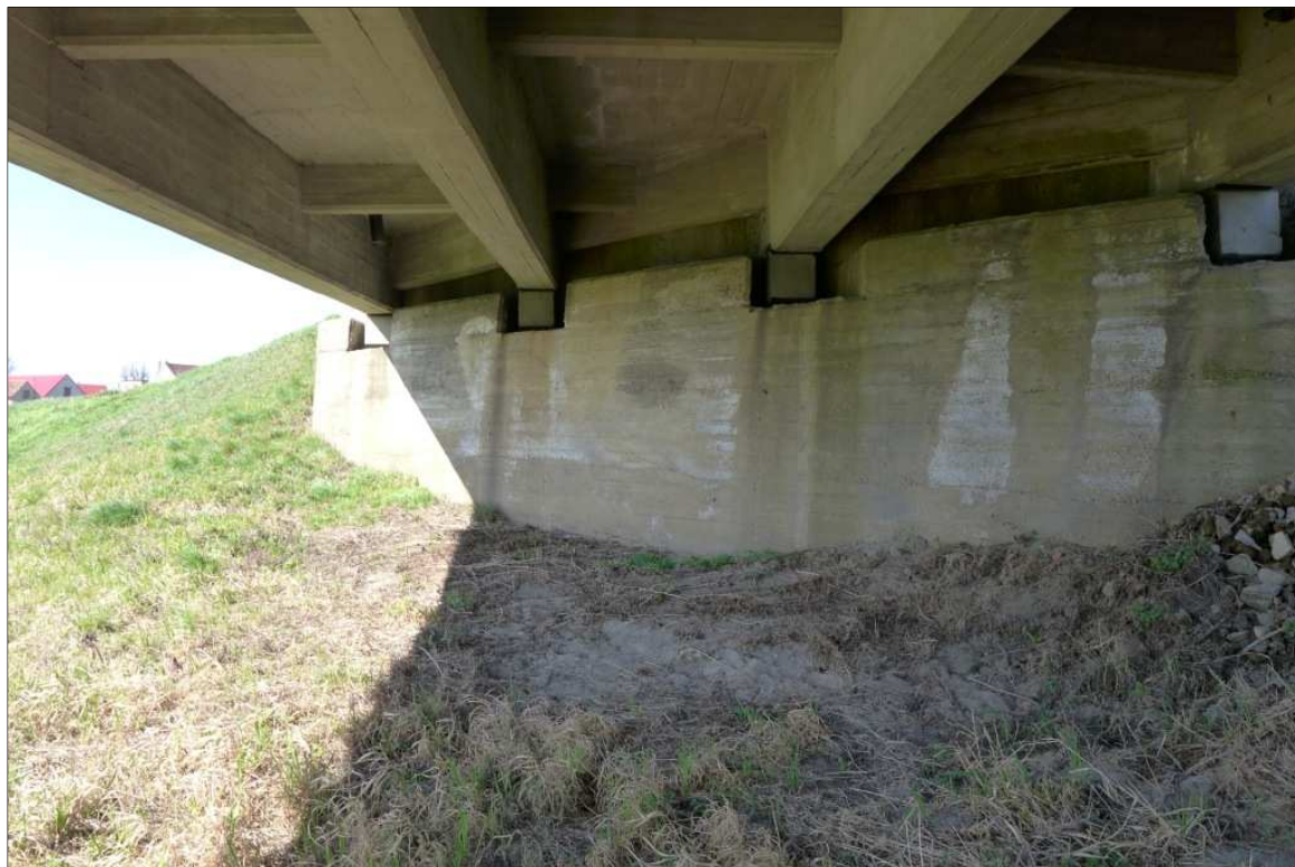
Fot. 25 – Przyczółek prawobrzeżny - widoczne osady i wykwity.
