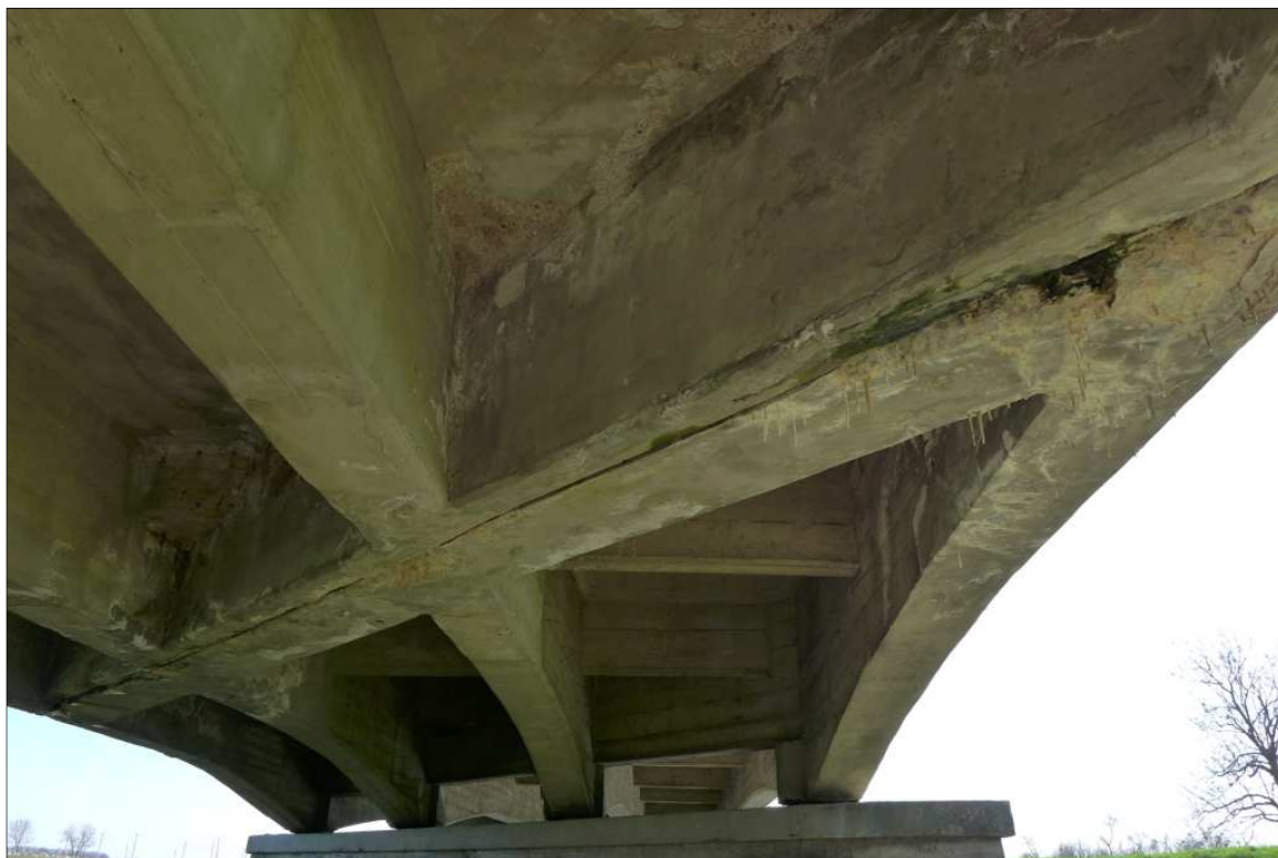
Fot. 16 – Konstrukcja nośna - rozległe osady, wykwity i stalaktyty na konstrukcji nośnej, na skutek przecieków wody przez przegub. Widoczna również korozja betonu.
