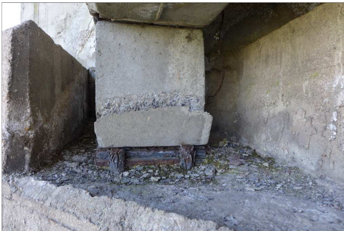
Fot. 30 – Łożysko betonowe - widoczne ospojenia betonu oraz korozja wżerowa i rozwarstwienie części stalowej łożyska oraz zanieczyszczenia niszy podłożyskowej.
