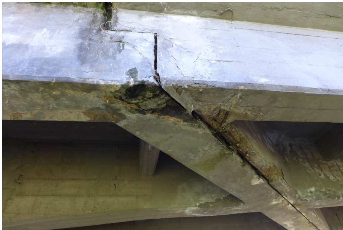
Fot. 17 – Konstrukcja nośna - widoczna rozległa korozja betonu i stali konstrukcji nośnej w miejscu przegubu, na skutek przecieków wody.
