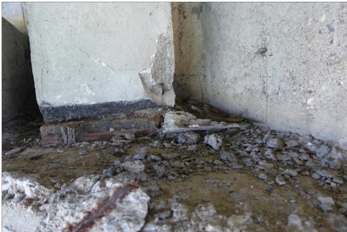
Fot. 29 – Łożysko betonowe - widoczne spękania i ospojenia betonu oraz korozja wżerowa i rozwarstwienie części stalowej łożyska oraz zanieczyszczenia niszy podłożyskowej.
