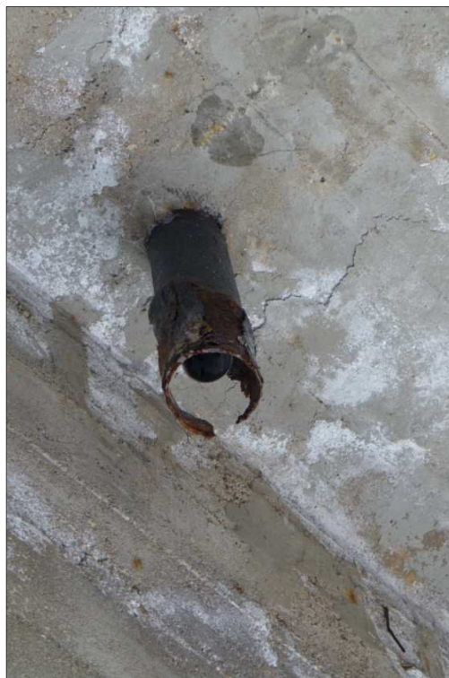
Fot. 24 – Rura spustowa - korozja powierzchniowa i wżerowa, białe wykwity na płycie pomostu w obrębie rury.
