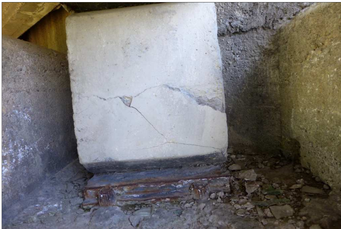
Fot. 32 – widoczne spękania i ospojenia betonu oraz korozja wżerowa i rozwarstwienie części stalowej łożyska oraz zanieczyszczenia niszy podłożyskowej.
