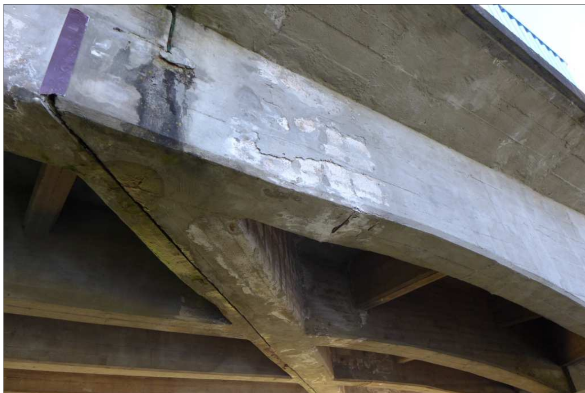
Fot. 22 – Konstrukcja nośna - widoczna rozległa korozja betonu i stali konstrukcji nośnej w miejscu przegubu, na skutek przecieków wody. Widoczne również przecieki i wykwyty.
